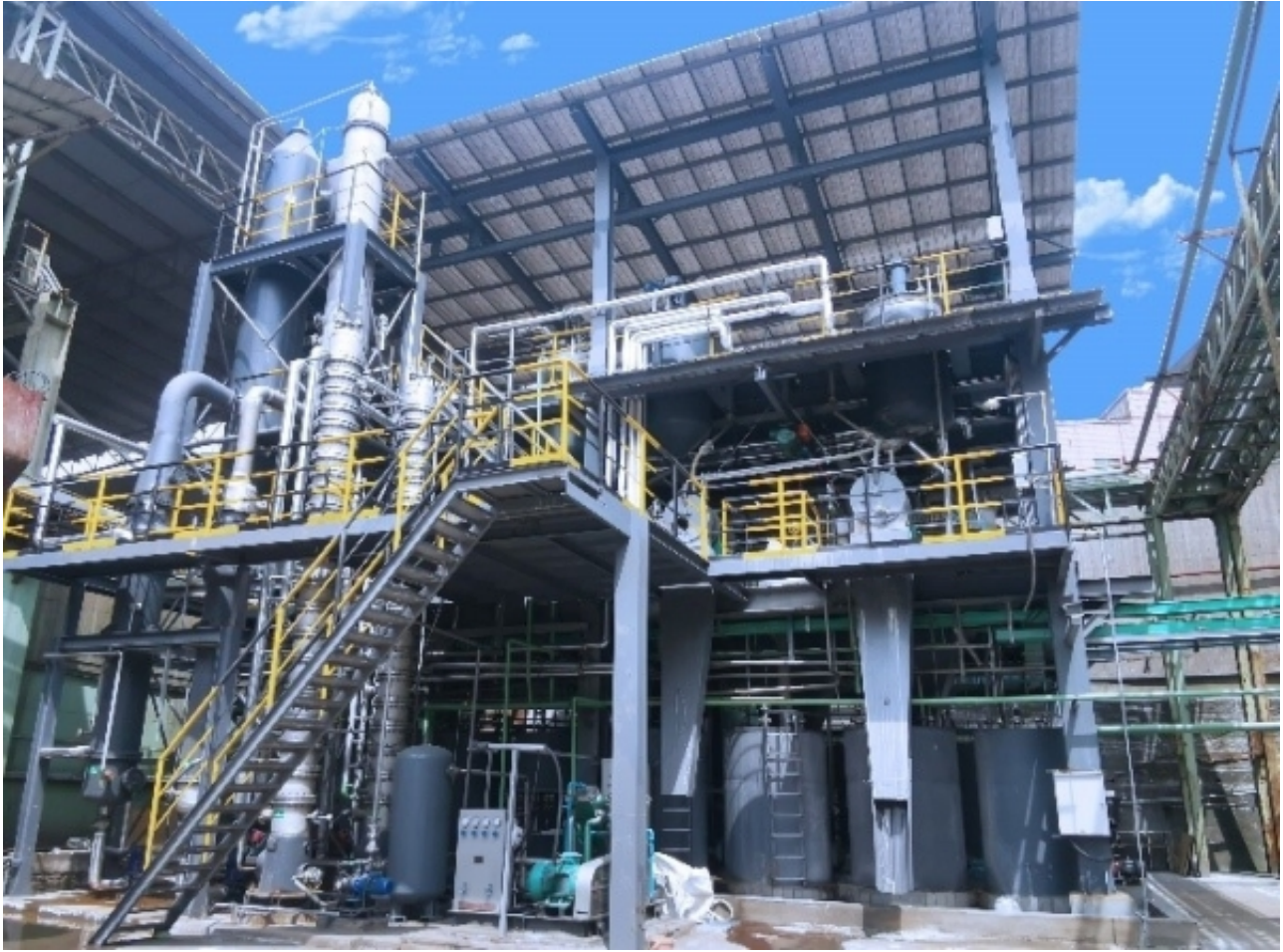
硫酸钠制纯碱项目部分装置
