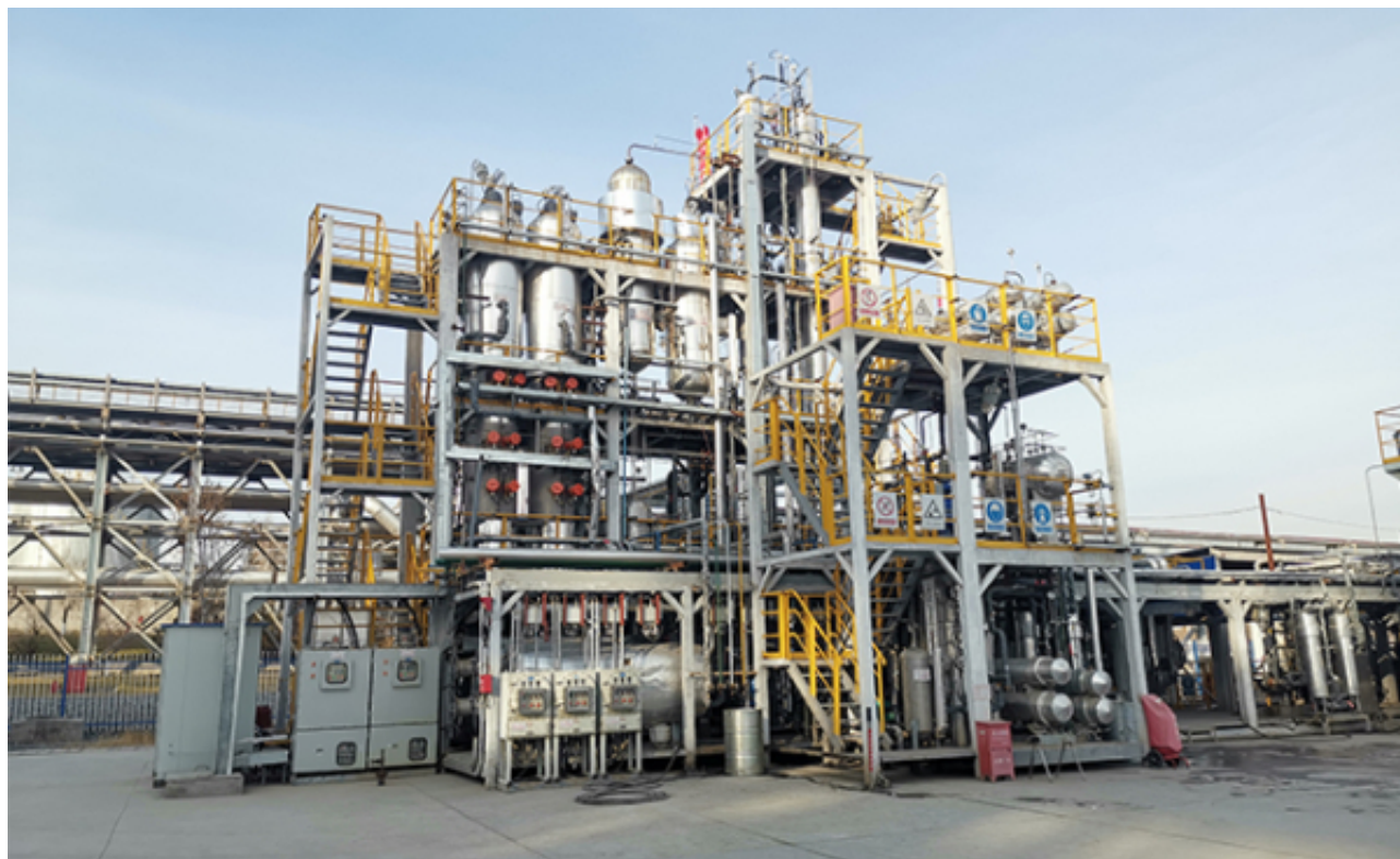
重质油悬浮床加氢千吨级装置
