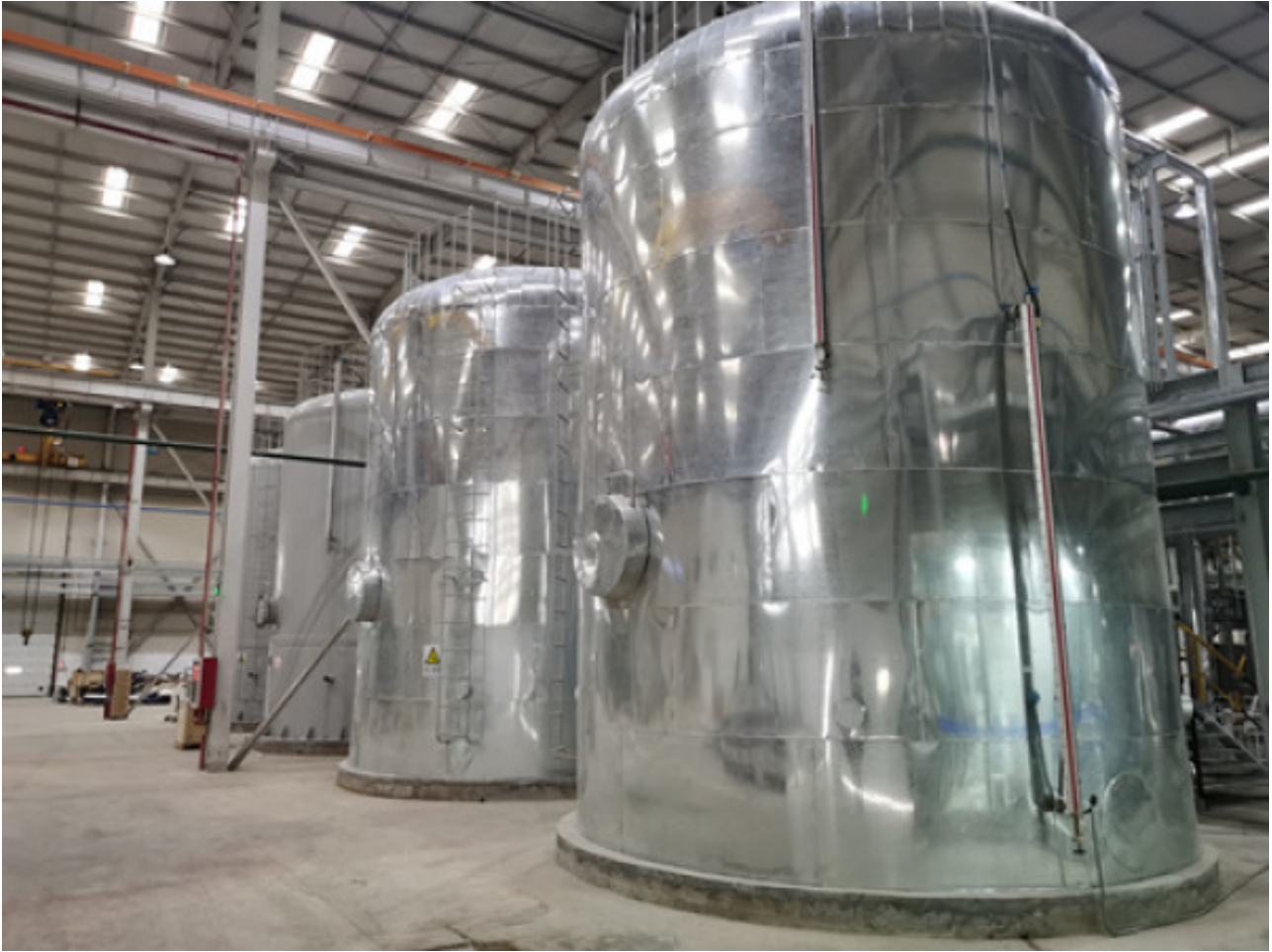
10MW级压缩空气储能系统蓄热装置
