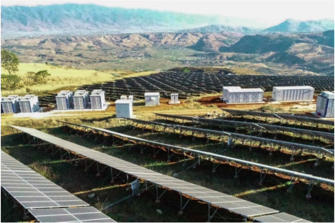
大型光伏电站直流升压汇集接入实证系统
