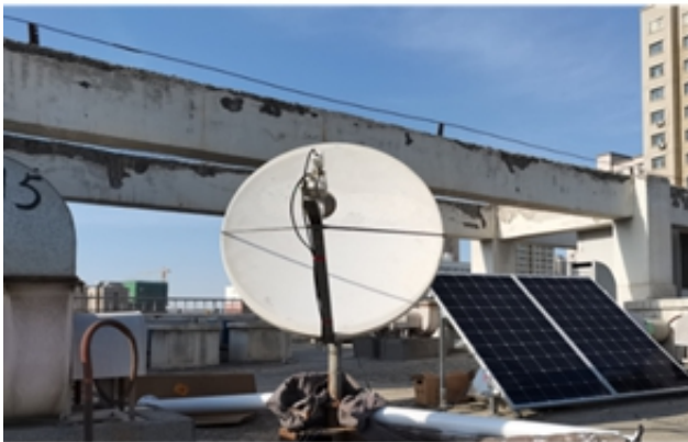
VSAT卫星通信系统
