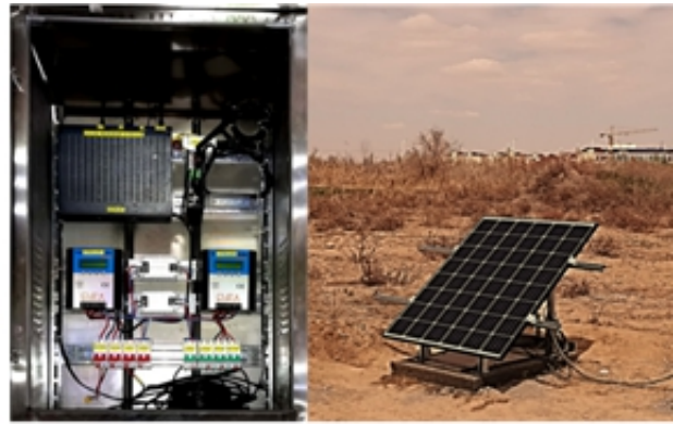
太阳能光伏供电系统
