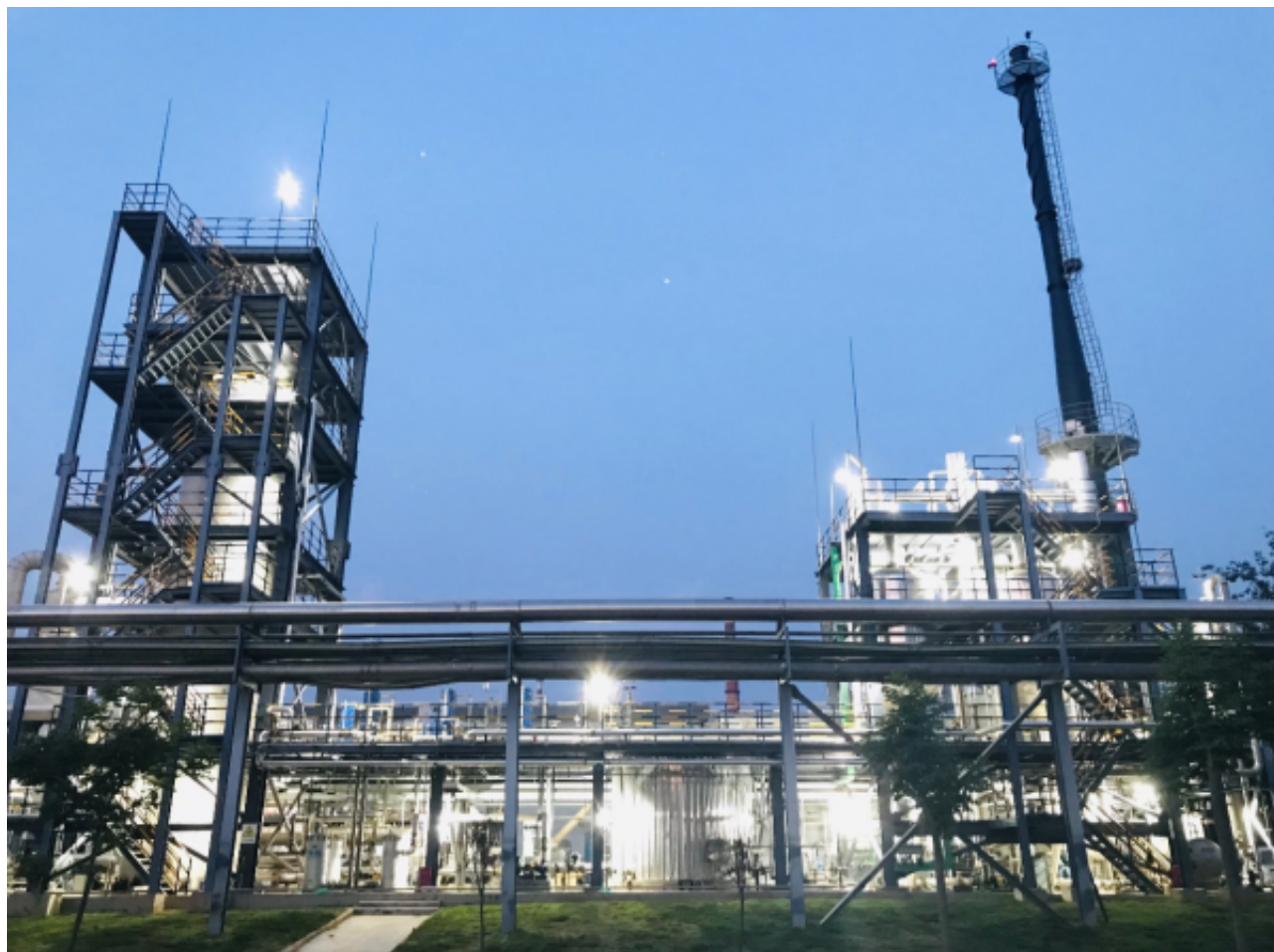
离子液体法钼化工尾气氨回收利用示范装置（陕西渭南）
