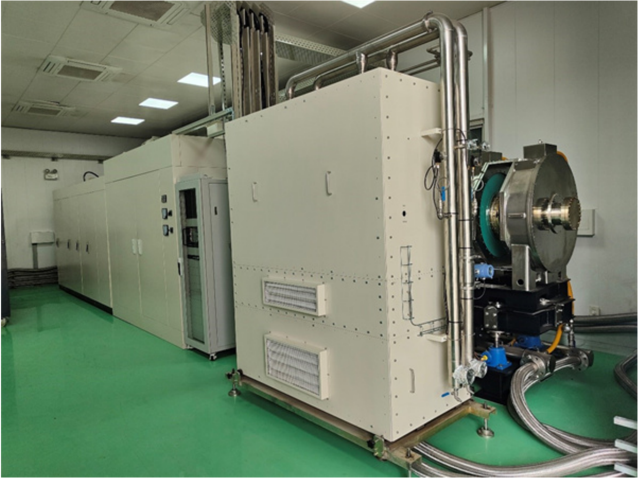
图1.高梯度、大带宽、快响应油冷磁合金高频系统
