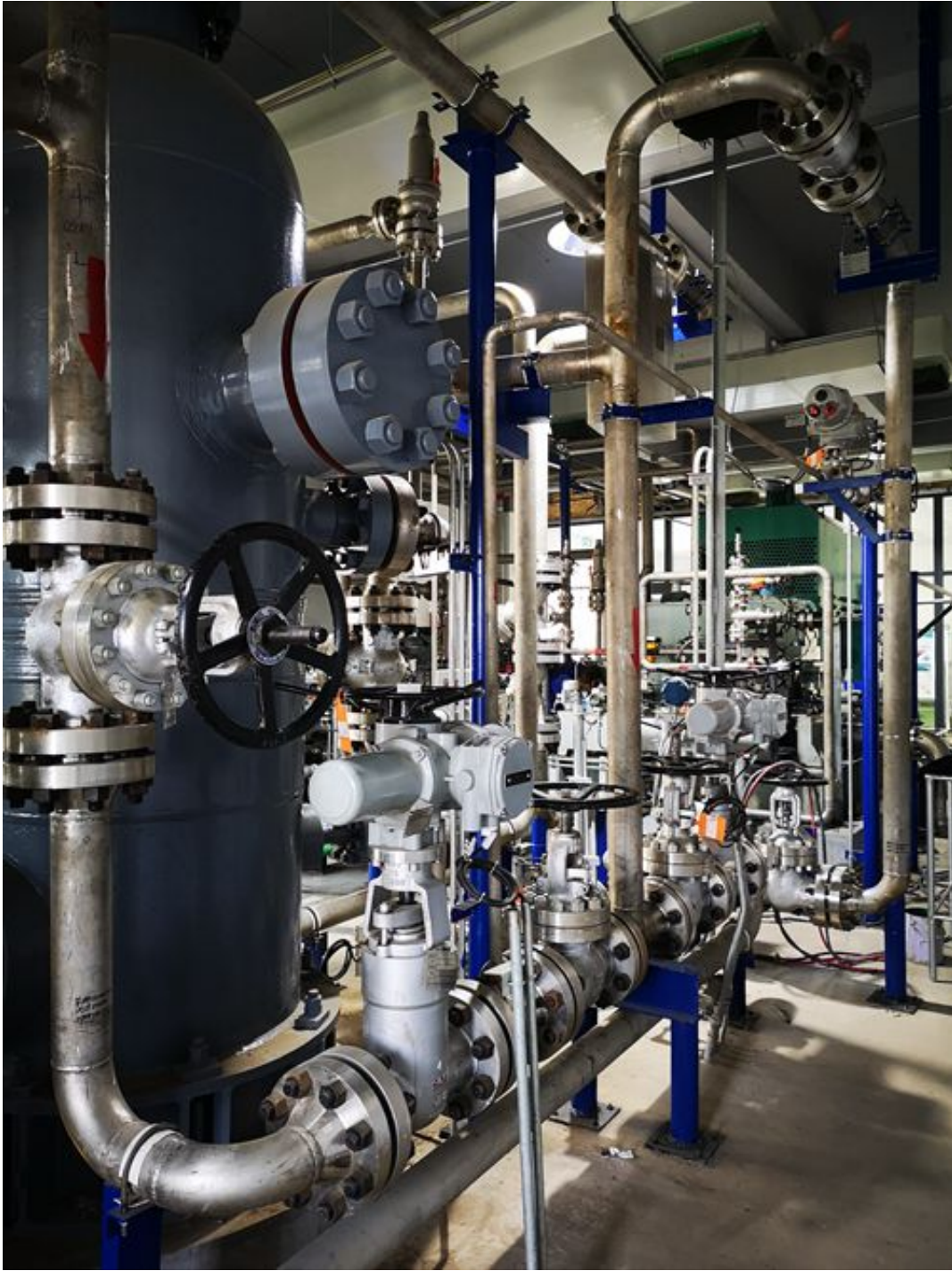
SCO2压缩机实验平台(测试系统)
