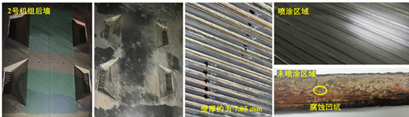
常乐电厂2号机组运行11个月后墙喷涂区域水冷壁表现形貌
