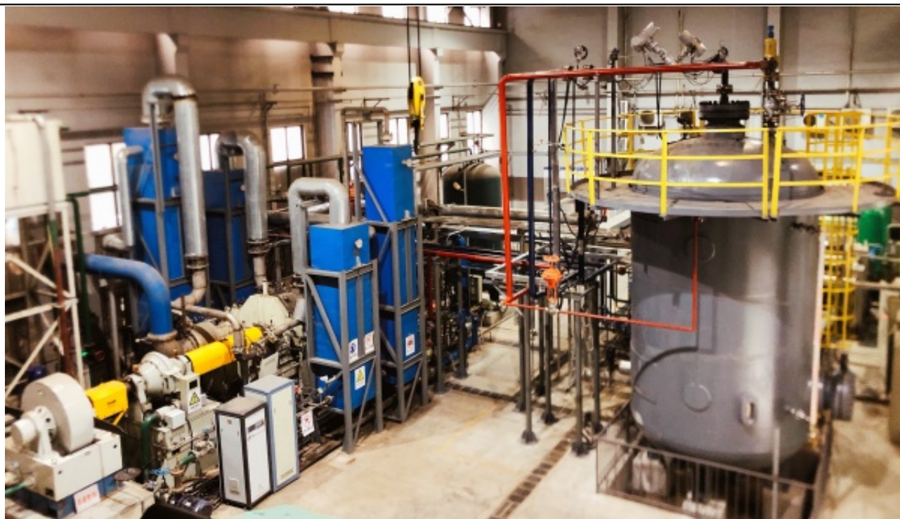
兆瓦级恒压压缩空气储能实验平台
