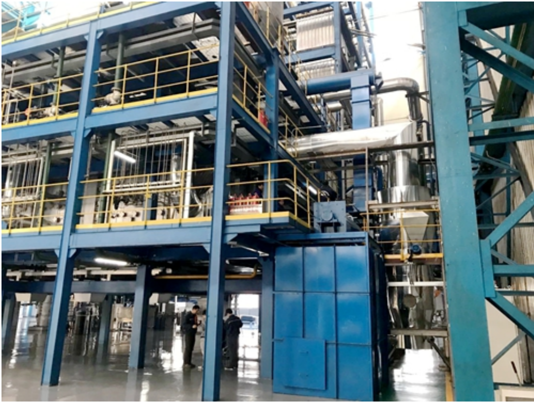
16MW内循环预热式燃烧器测试平台
