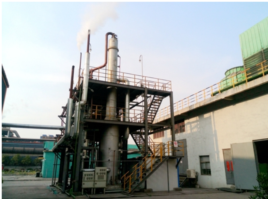
图1 异丙醇-丙酮-氢气化学热泵技术验证示范平台
