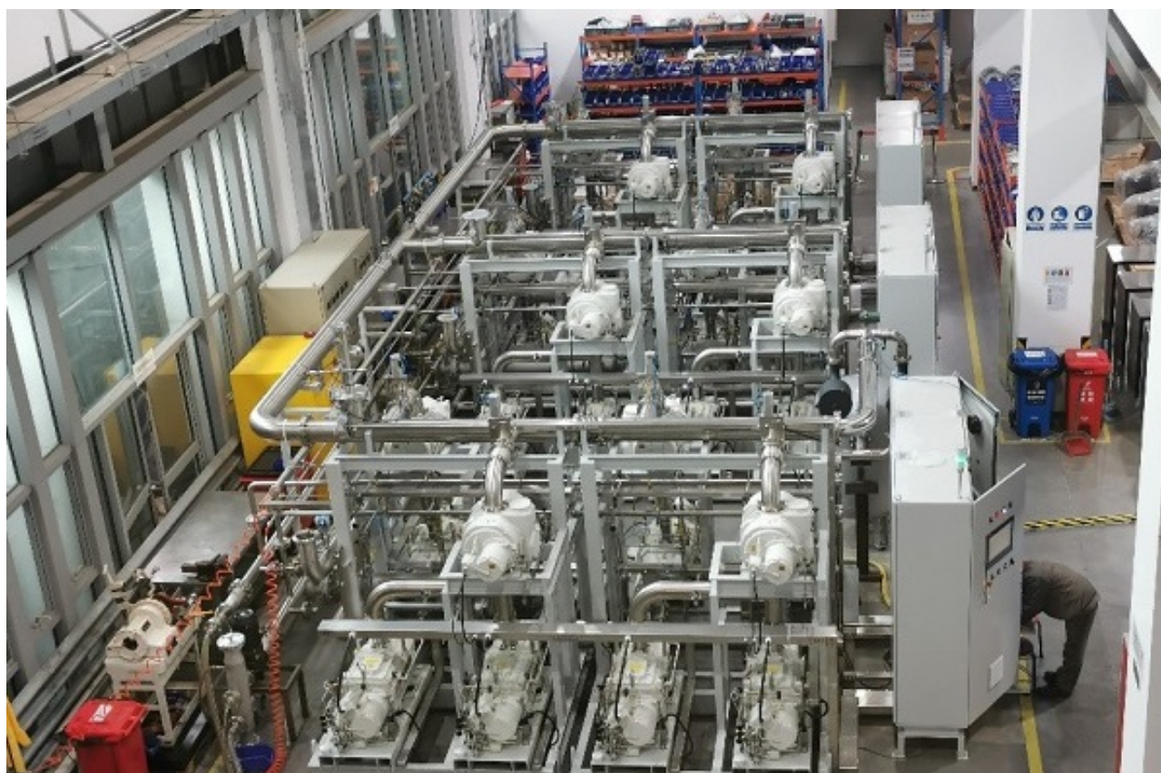
PAPS平台2K减压降温干泵验收现场照片
