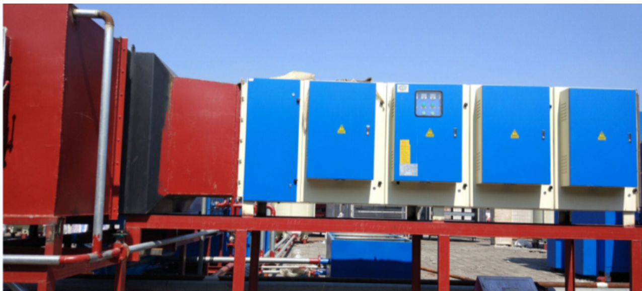
光催化处理印染定型机VOC废气处理装置
