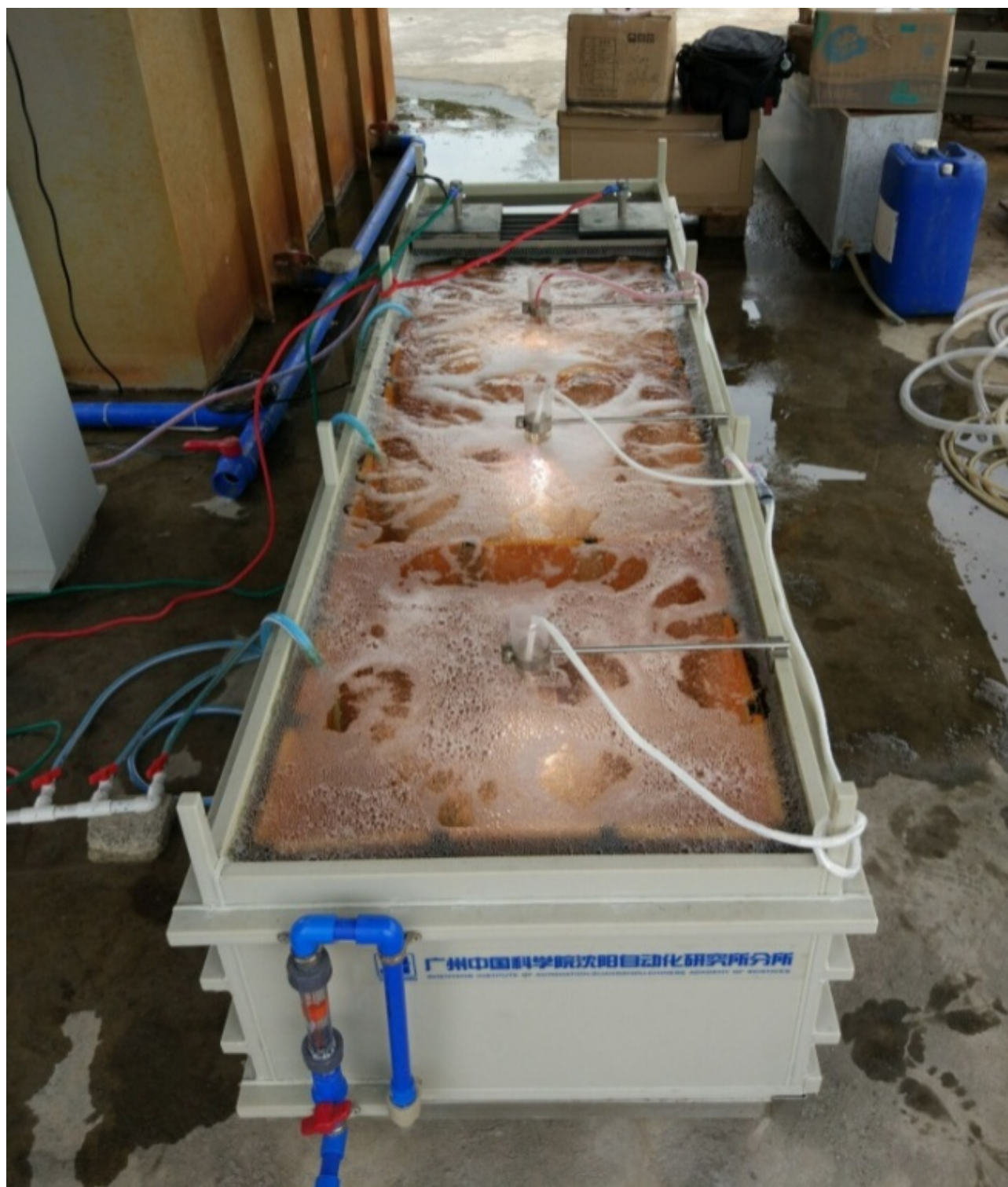
光催化工业废水（中试）处理装置
